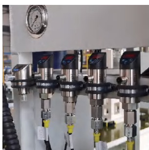
冲孔机压力监测
